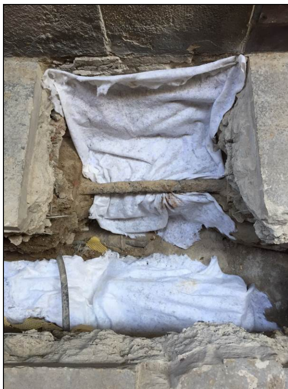
36. Cobriment amb geotèxtil de les restes de la fonamentació d'un dels pilars de l'aqüeducte romà de la ciutat de Barcino .
