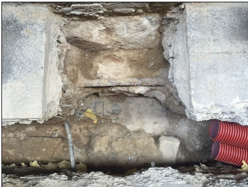
31. Fonamentació de l'aqüeducte en el moment d'instal·lació de les tubulars per al servei elèctric.
