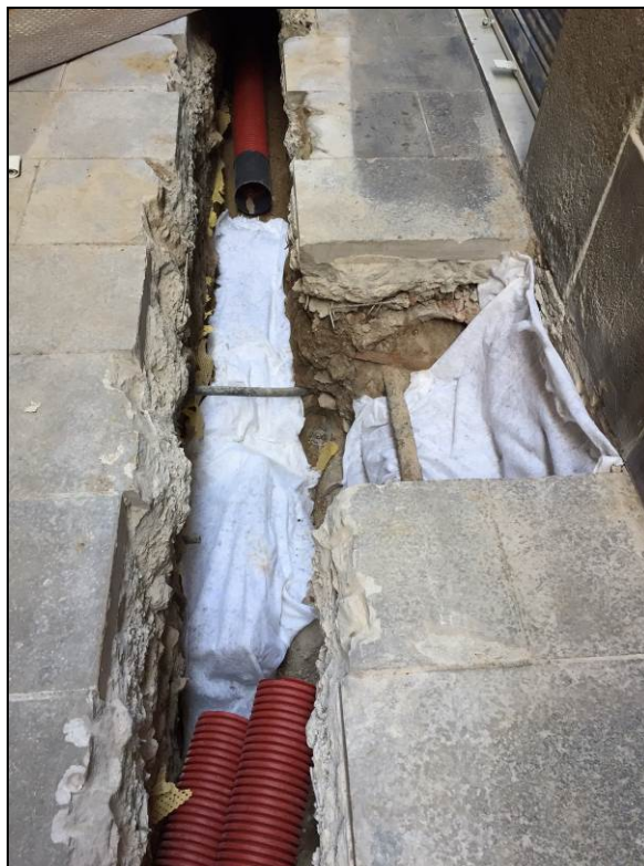
35. Cobriment amb geotèxtil de les restes de la fonamentació d'un dels pilars de l'aqüeducte romà de la ciutat de Barcino .
